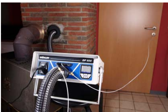
Afb. 39: Wöhler DP 600 met aangesloten capillaire leidingen tijdens de 4PA meting
